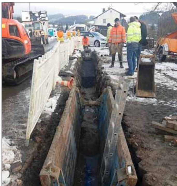
Der Bauabschnitt im Mühlenweg Haßlach bei Teuschnitz ist nur eine von 13 Maßnahmen, die heuer über die Bühne gehen. Der Leitungsbau ist bereits zu 90 Prozent abgeschlossen. Derzeit laufen die Restarbeiten, die noch im Dezember abgeschlossen werden sollen.
